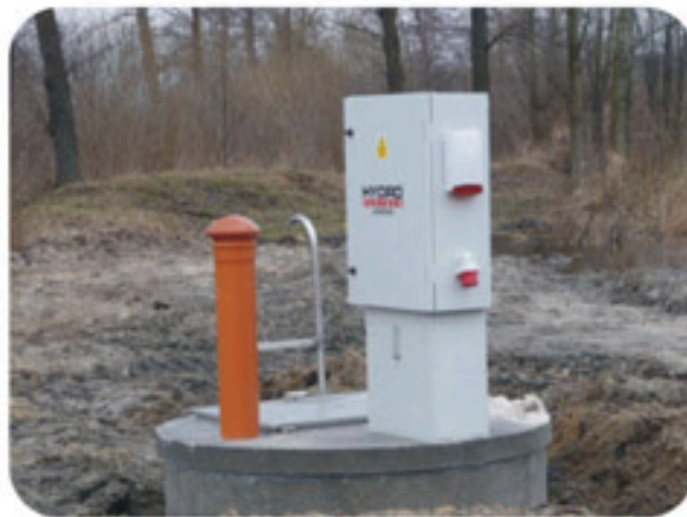
Przepompownia ścieków Orchów
